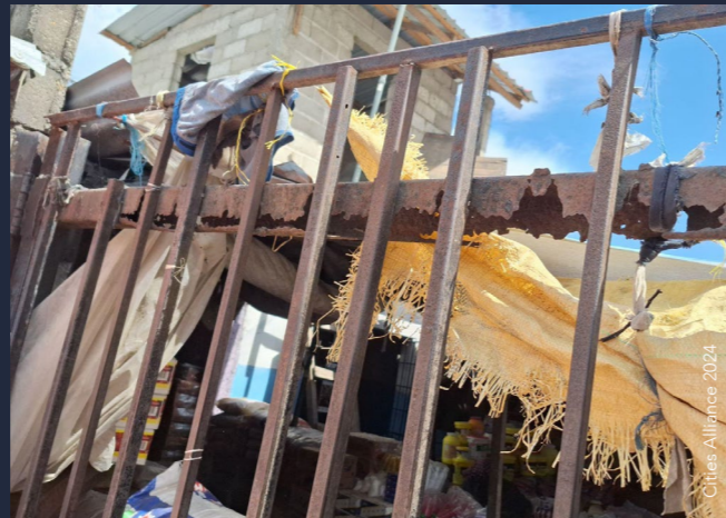
Figure 29 - Dégâts aux infrastructures marchandes
