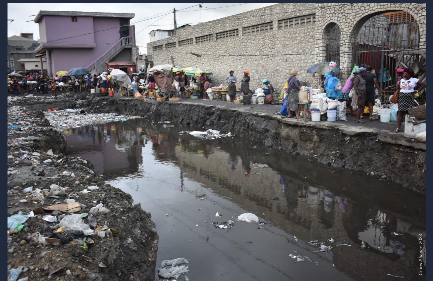
Figure 33 et 34 - Blocage des drainage et risques d'inondation
