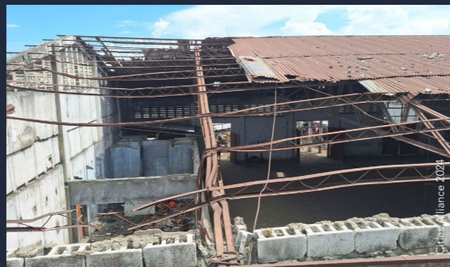
Figure 28 - Dégâts structurels du toit
